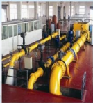
开式水泵试验台
